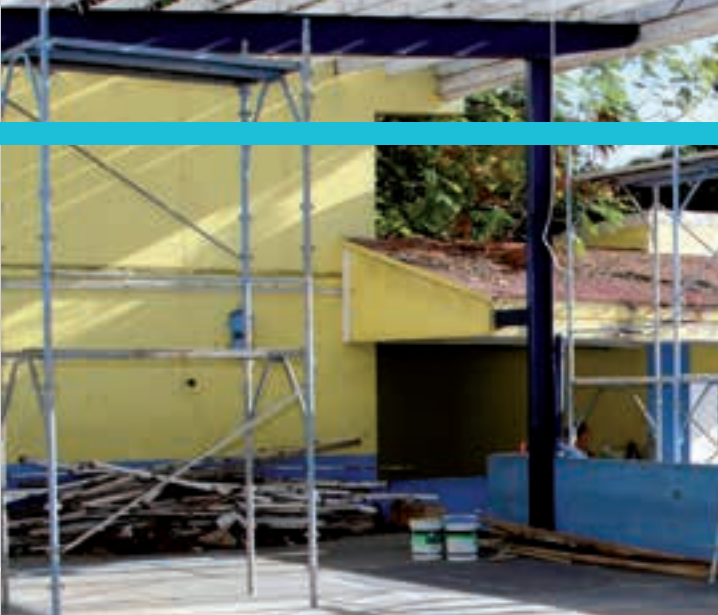
Sloopfase van het hoofdgebouw en de gymzaal van de Golden Rock school.
