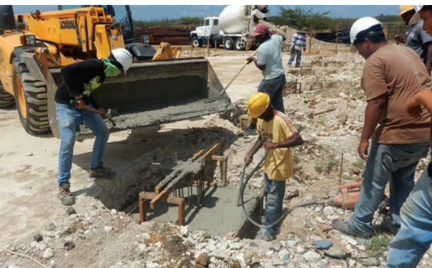
Twee stagairs (met witte helmen) aan de slag met het storten van de fundering
